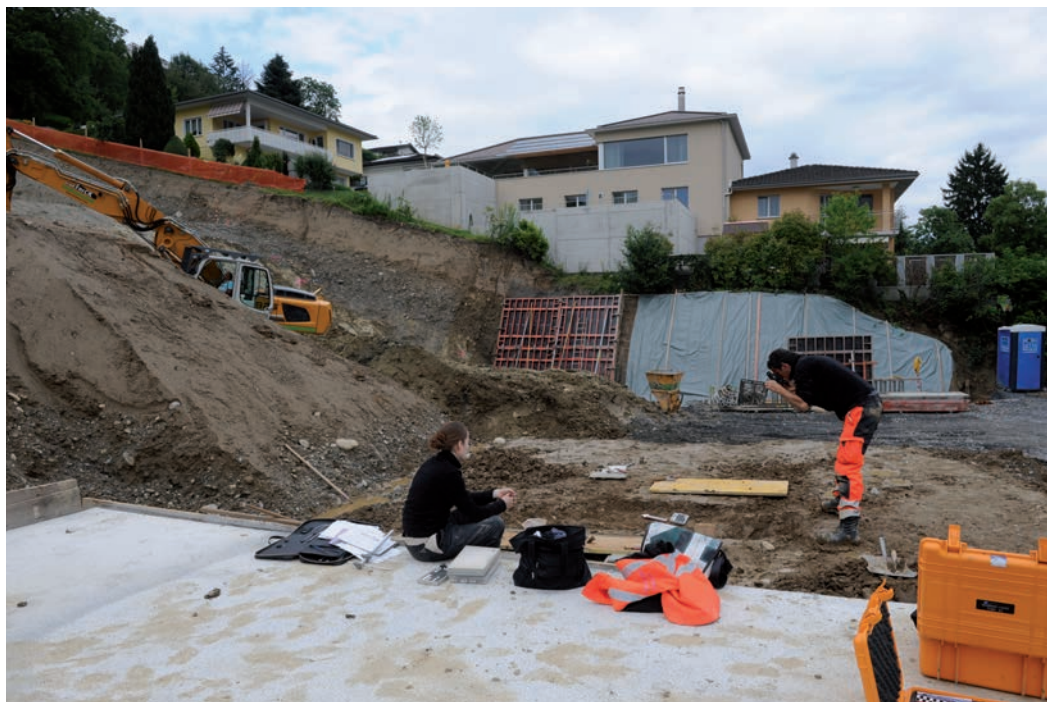
Abb. 2: Notfallmässige Befunddokumentation auf der Baustelle.
