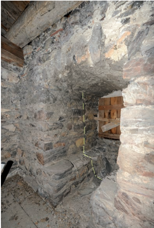
Abb. 19: Balzers, Burg Gutenberg. Baufuge in der südlichen Fensterlaibung des Turms.
